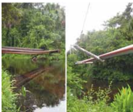
Figura 9. La falta de mantenimiento de tuberías puede provocar su ruptura y ocasionar la contaminación masiva por petróleo de los ríos de morichal.
